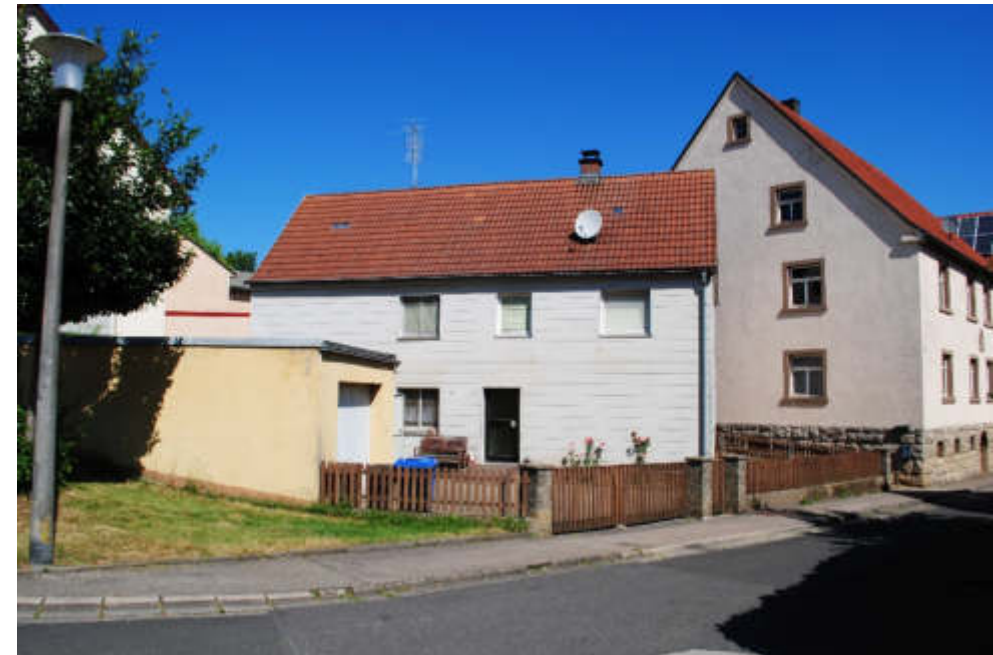
Abb. 122 – Südliche Traufseite – Mit Zementplatten flächig verkleidet
