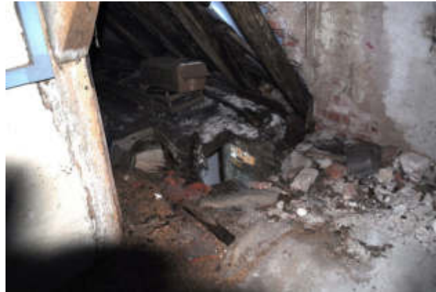
Abb. 098 – Wasserschaden im Traufbereich
